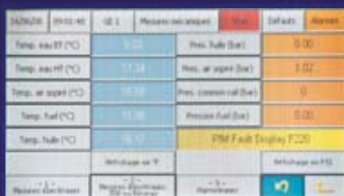
4- Ecran de mesures mécaniques
