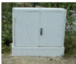
Coffret de commande et de télégestion en armoire
