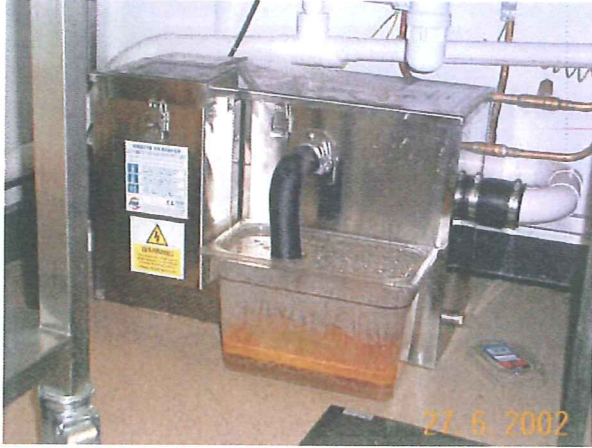
Installation sous plonge
